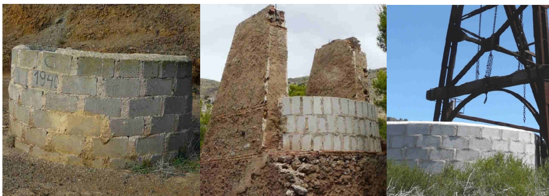
Ilustración 2. Ejemplos de brocales de bloques de hormigón, que son los más frecuentes en los pozos de la Sierra Minera. De izquierda a derecha, minas Carolina La Doncella, Precaución y La Pagana.
