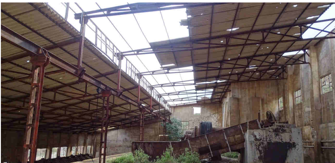
Ilustración 7. Cubierta de fibrocemento peligrosa en el lavadero de la Mina N º 5 a de Montserrat, en el Cabezo Rajao.
