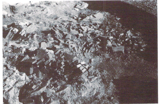
Habitación 10. Derrumbe de ladrillos y tejas.
