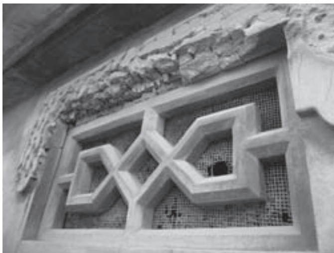
Imagen 7. Deterioro de cargaderos
