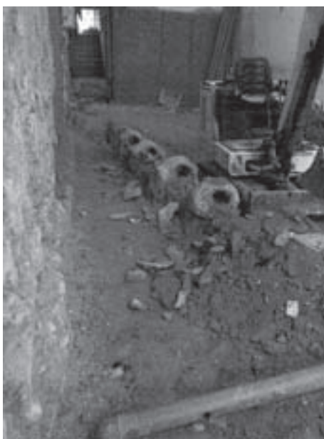
Imagen 5. Rotura del saneamiento original. Al fondo se observa el maestreado
