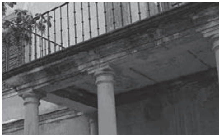
Fig 7. Humedad por filtraciones.
