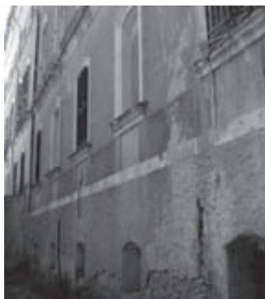
Fig 8. Humedad por capilaridad.
