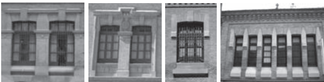
Imágenes representativas de la gran variedad de huecos de ventanas existentes en este edificio escolar.
