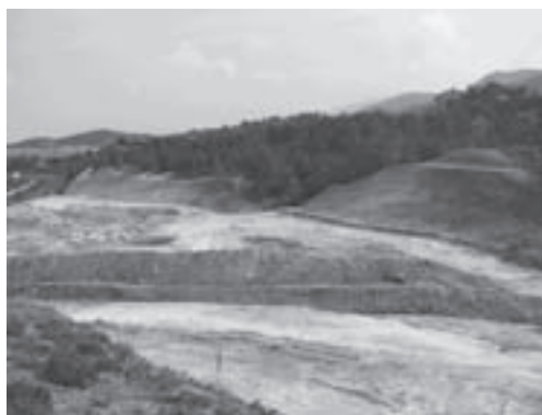
Fig. 3. Panorámica de alguno de los taludes que afectaban a los afloramientos fosilíferos en VLP.
