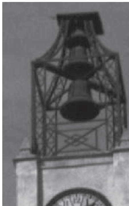
Figura 11. Estructura metálica sobre la torre del templo que ha sido recientemente eliminada.
