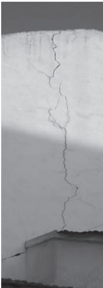
Figura 13. Grieta longitudinal en lo alto de la fachada trasera.
