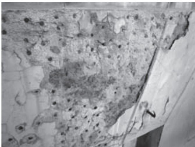
Imagen 6. Deterioro paramentos y corrosión clavos acero
