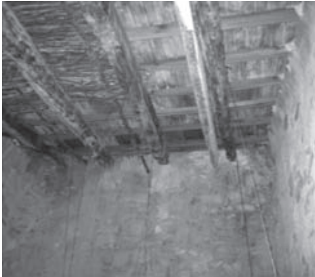
Figura 12. Cubiertas de madera del piso alto en el estado previo a la restauración de la iglesia de San Roque.
