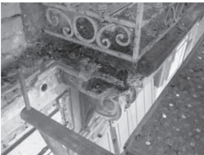
Imagen 9. Deterioro y corrosión de losas de balcones
