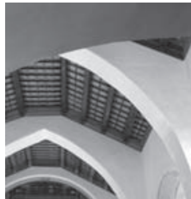
10. Nave central con estructura de arcos diafragmáticos y techumbre a cinta y saetino. Foto: FJLM.
