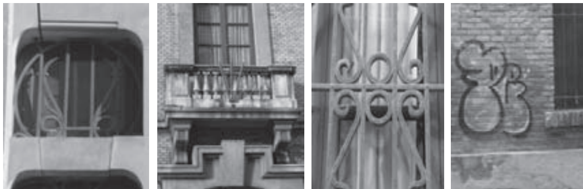
De izquierda a derecha: Grieta en dintel de ventana de un de las fachadas laterales. Efectos de la contaminación ambiental apreciables en la balaustrada del balcón de la primera planta de la fachada principal. Oxidación de una de las rejas de ventanas. Uno de tantos grafitis existentes en las fachadas de este edificio escolar.
