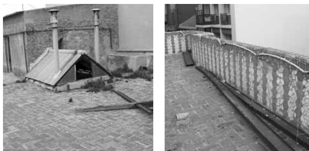
Figura 9. Detalle exterior del casetón de escaleras, tragaluz y del pretil de cubierta. Rematado superficialmente con el uso del «trencadís».
