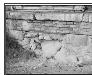
Detalle alteración de la piedra.
