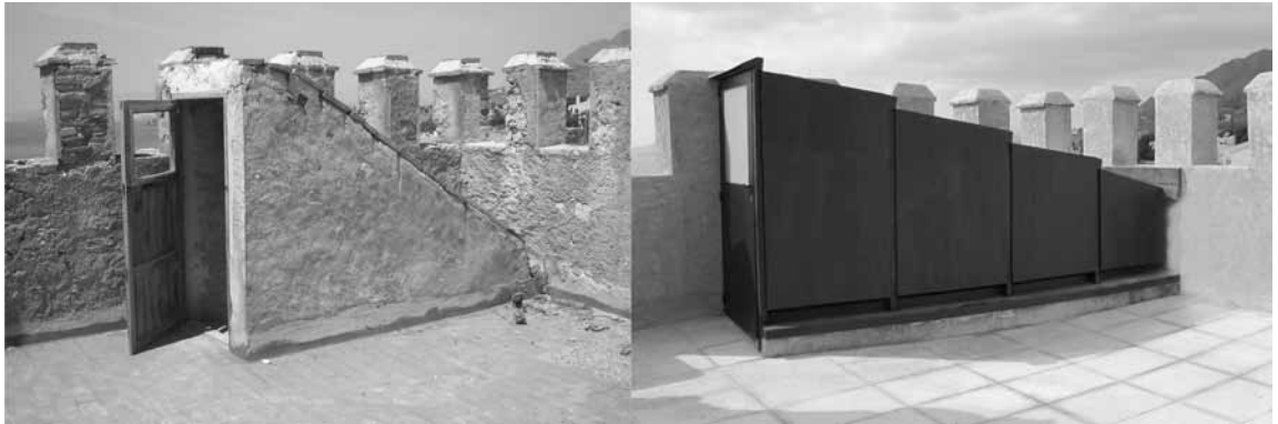
Figura 6. Cubierta de la torre y salida de escalera, antes y después de la actuación.
