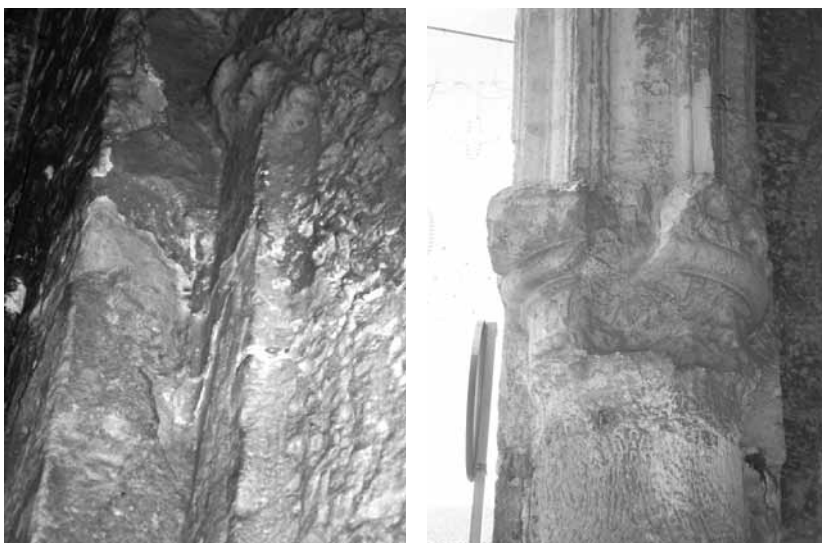
Figura 5. Distintas capas de revestimiento y rotura de capiteles.
