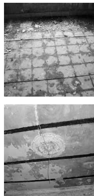
Figura 13. Cara inferior y superior de forjado. La constante acumulación de agua de lluvia, proveniente del hueco dejado por la desaparición de la carpintería exterior, provoca la inherente corrosión de los elementos metálicos y la disgregación de los elementos compositivos del forjado, con la consiguiente abertura de juntas de solado y levantamiento de piezas de baldosas hidráulicas.
