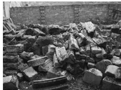
Figura 4. Parte de las piezas que formaban la bóveda que cubría el presbiterio situadas en el interior de éste en el suelo.
