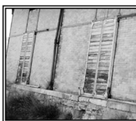
Zócalo con piedra dañada
