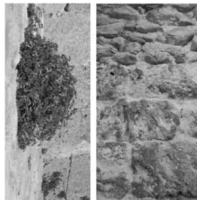
Figura 9. Biodeterioro y Eflorescencias en los paramentos de la fortaleza caravaqueña.
