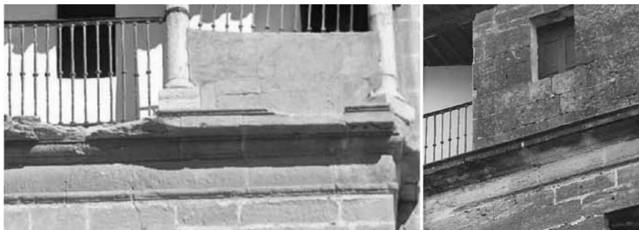
Figura 6. Diversas patologías localizadas en el Corredor del Conjuratorio.
