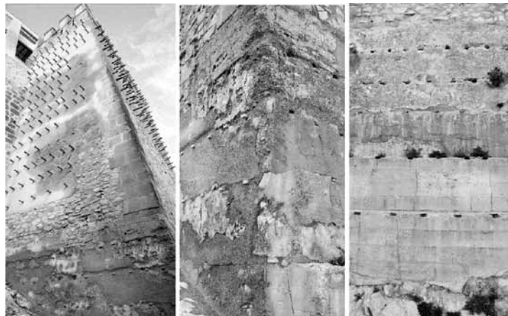
Figura 4. Patologías encontradas en los muros de tapial de la Torre Chacona.
