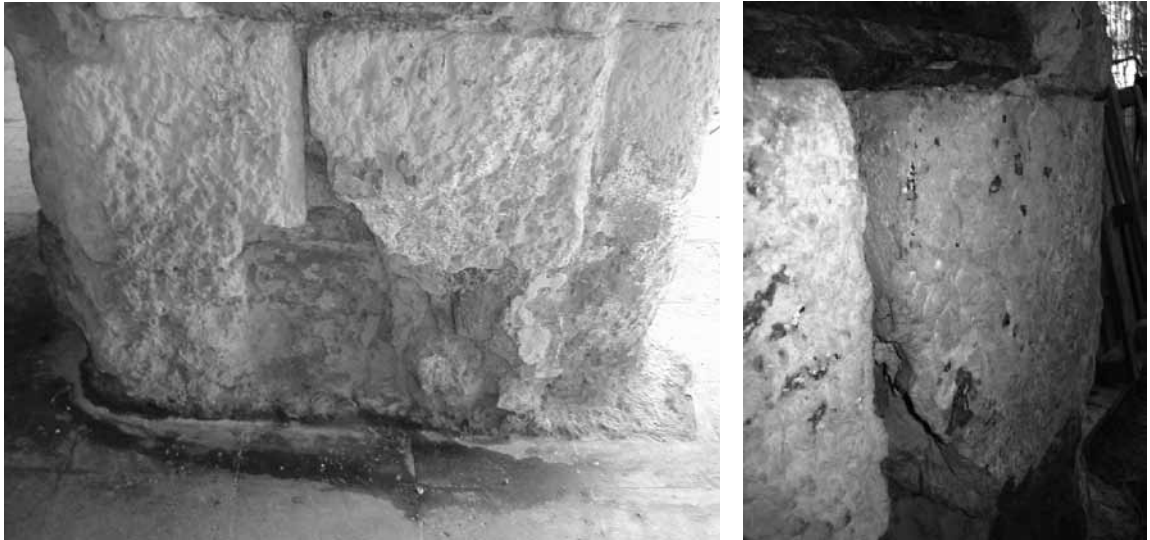
Figura 4. La fisura llega a provocar una desplazación del sillar.
