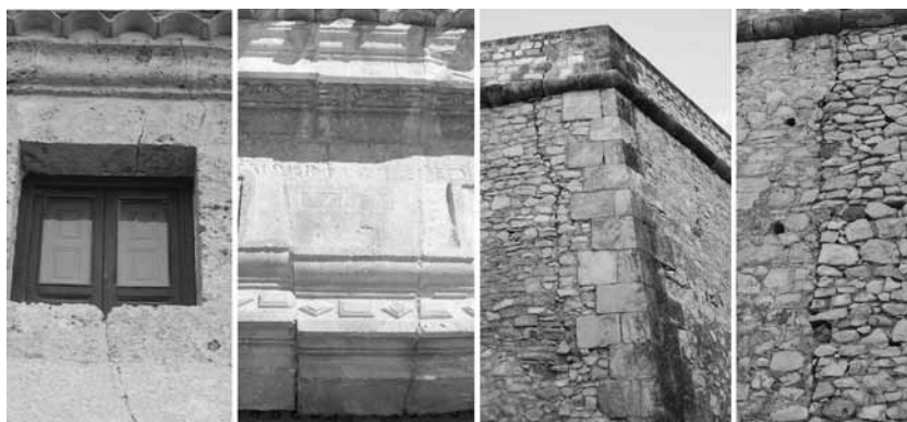
Figura 5. Grietas situadas en diferentes sitios de la fortaleza y Basílica-Santuario de la Vera Cruz de Caravaca.
