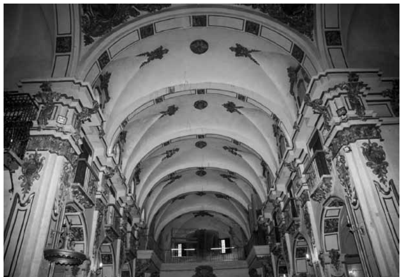
Estado inicial de la iglesia del Convento de La Merced
