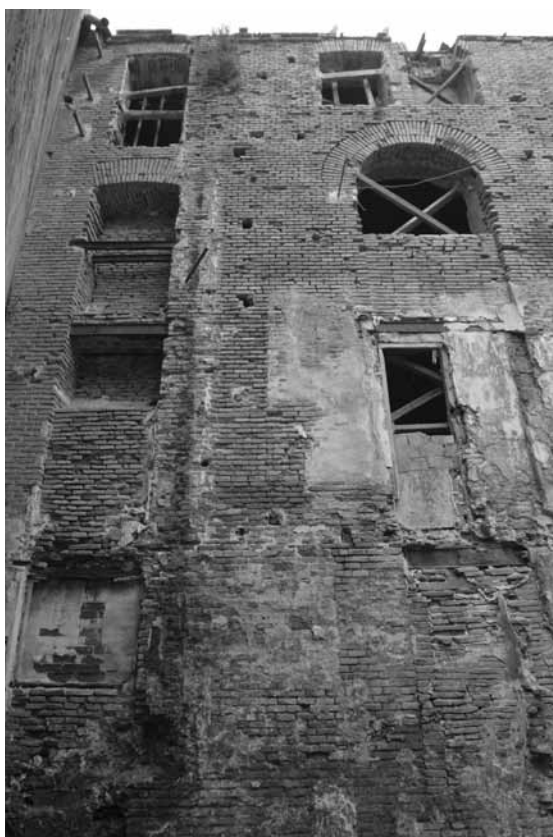
Figura 11. Aspecto original fachada deteriorada antes del inicio de la obra.
