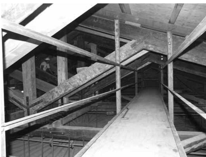
Figura 21 donde se aprecia la instalación de una ligera pasarela bajo la cubierta, sin tocar nunca el techo de la sala, que permitirá el fácil y cómodo mantenimiento futuro, además de la posibilidad de colocar instalaciones de luz, sonido, etc. para el teatro.
